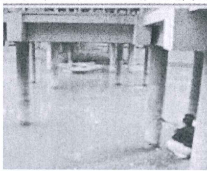
(d)RC桥墩盐冻侵蚀破坏
