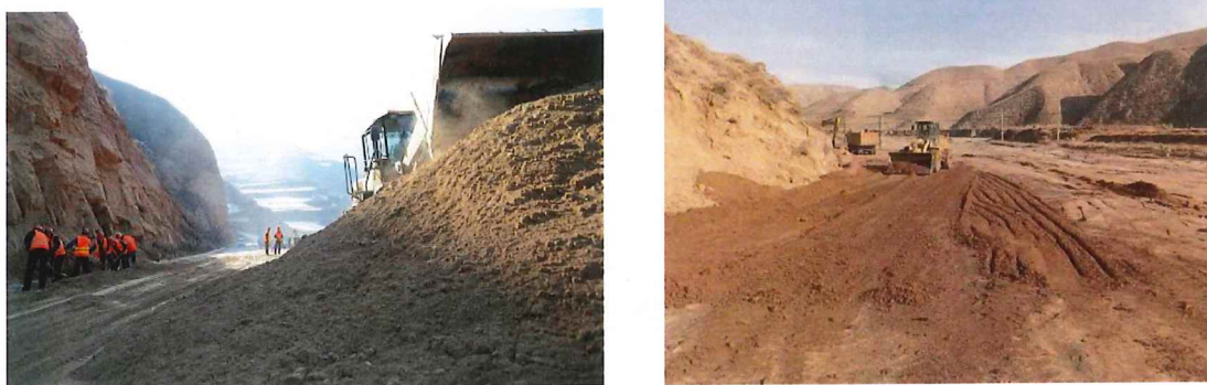
图 1.1 黄土滑坡现场照片
