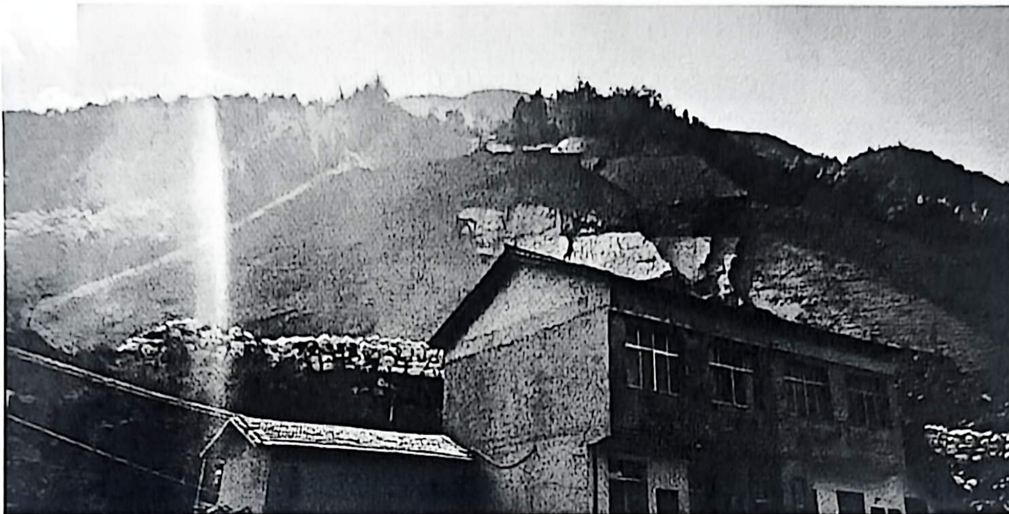
图 2 秦巴项目段部分边坡损坏
