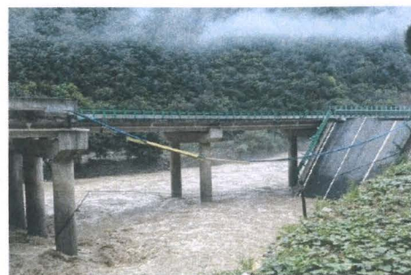
(2) 丹宁高速公路桥梁被山洪冲垮
