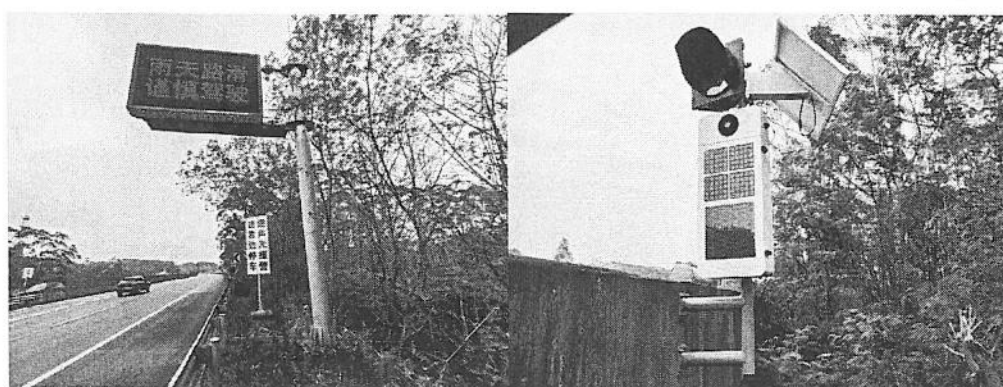
图 2.2.1-3 广明高速公路边坡预警设备
