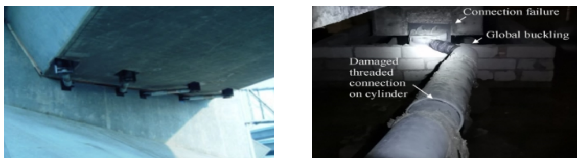
图 3 粘滞阻尼器在桥梁中的应用及其失效方式
