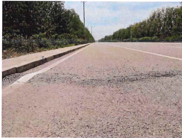
图 1. 路面隆起（“搓板路”）病害
