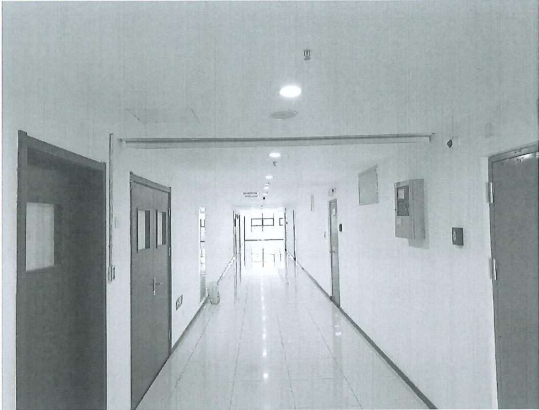
5、楼梯间电动防火门，联动后未关闭
