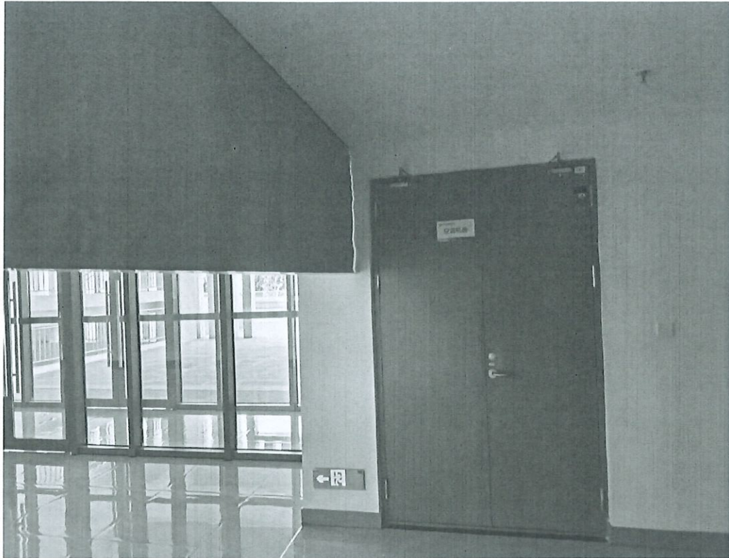
3、部分排烟口没有风速，可能是排烟阀未正常开启
