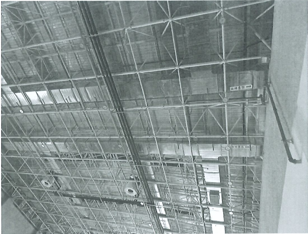
8、综合馆联动测试排烟风机未启动
