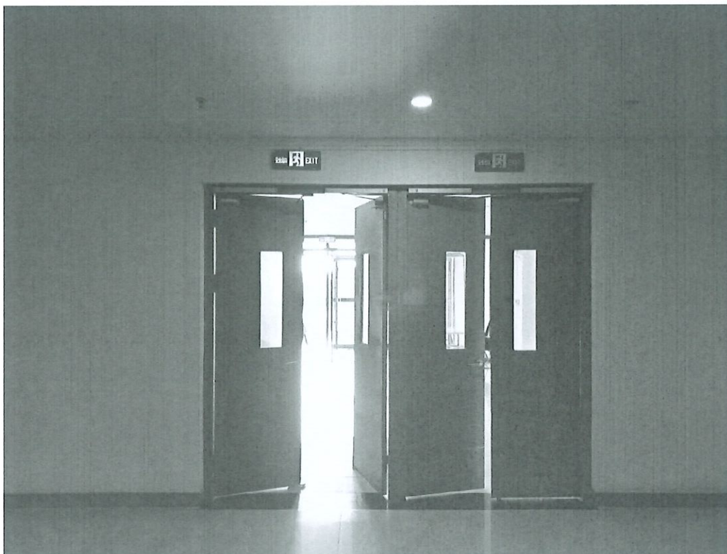
16、一楼体操训练馆排烟未启动
