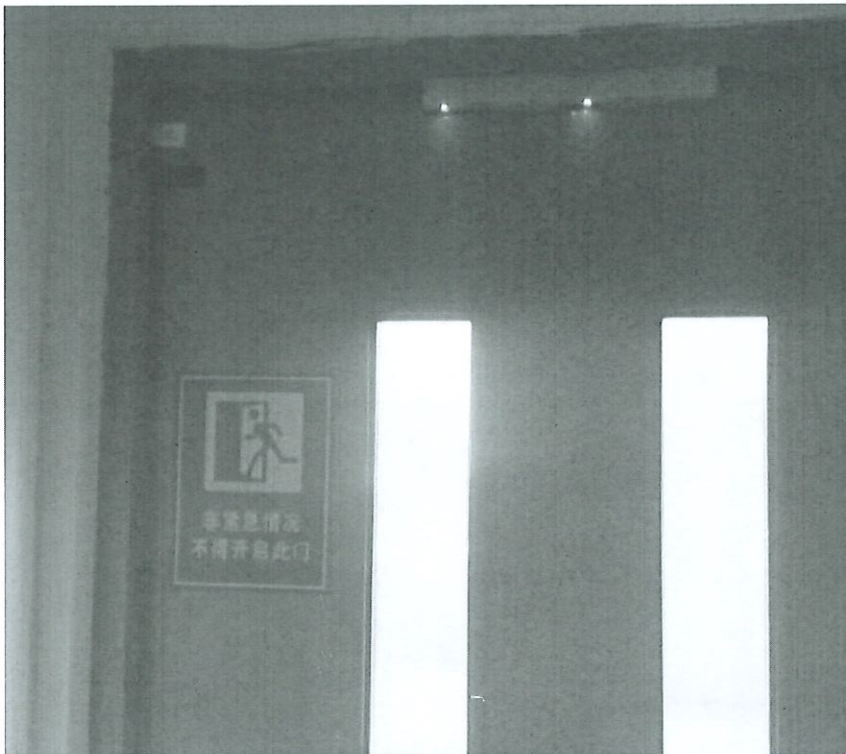
6、科研楼电动挡烟垂壁 7层到 13层没有就地手动控制装置
