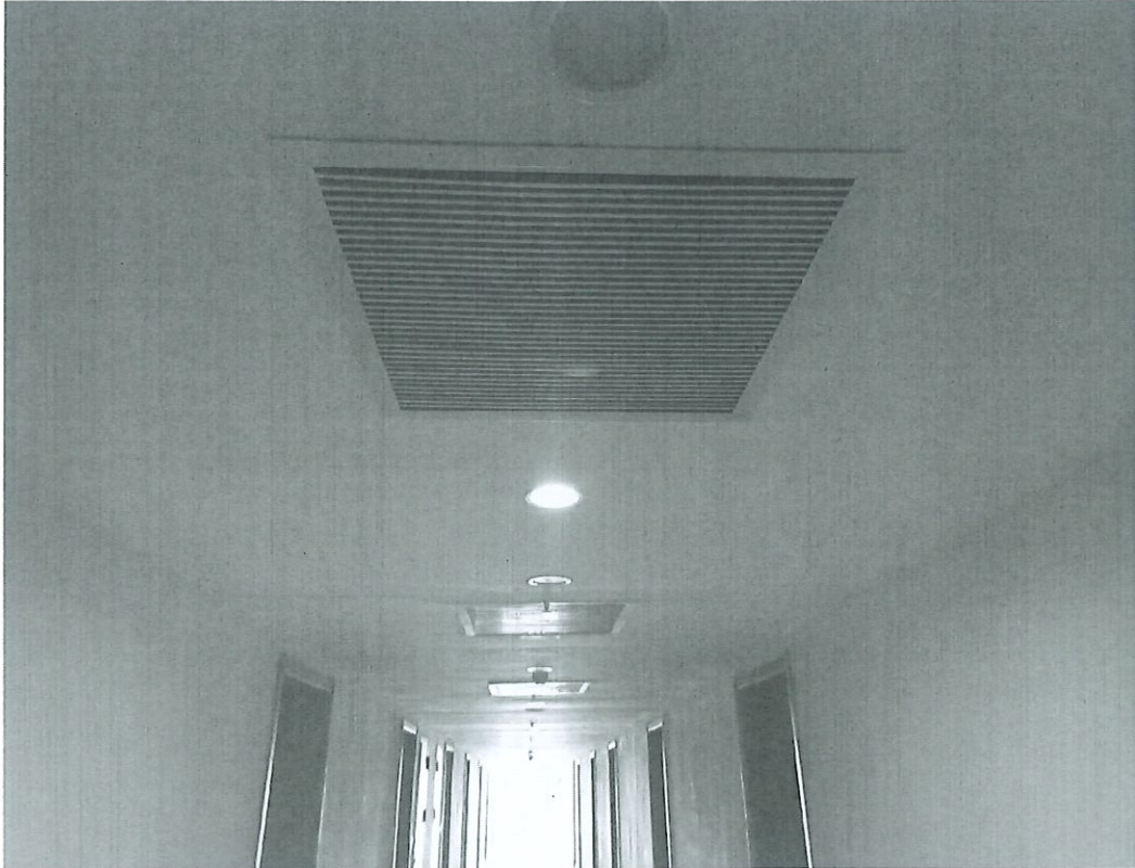
7、联动测试，走道东消防前室一台送风机未启动，风口无风速
