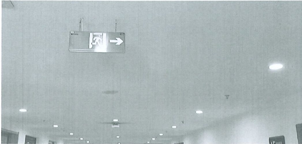
5、五楼联动测试，应急照明没有点亮
