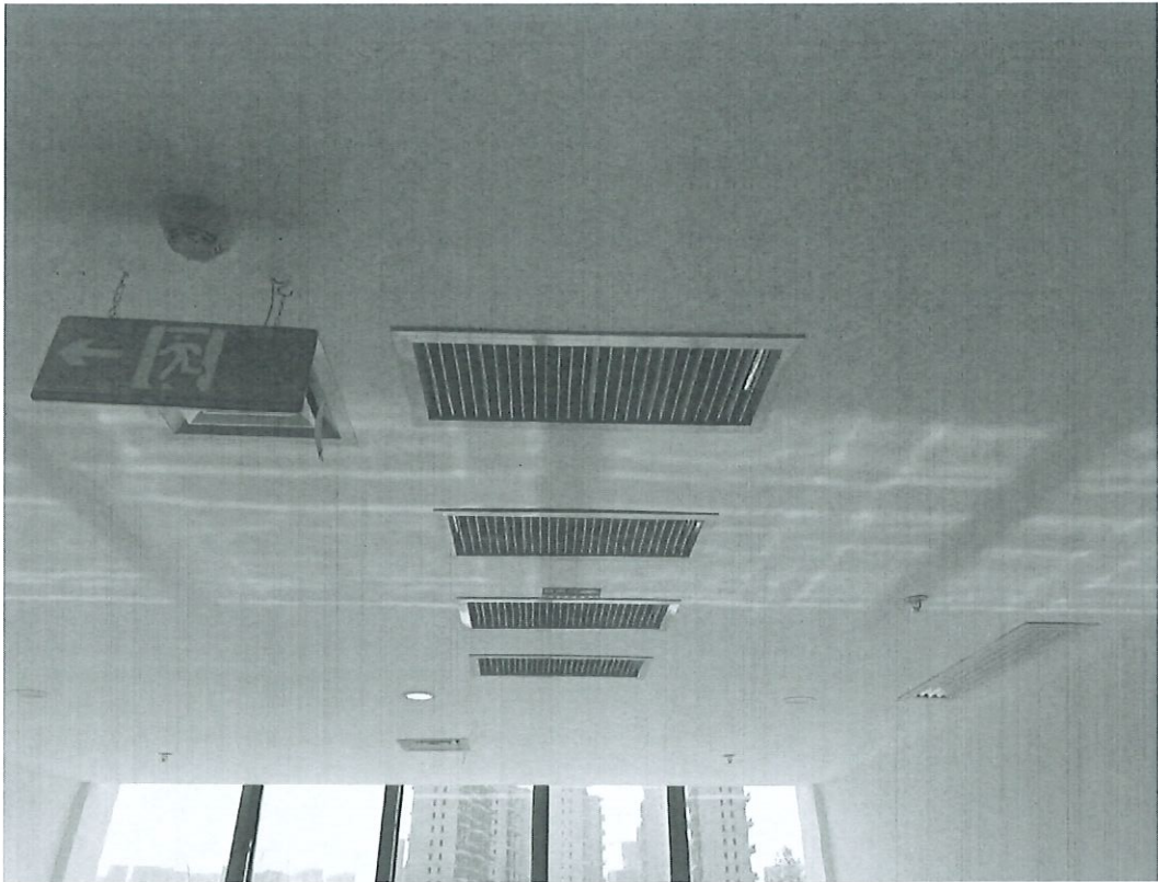
3、四楼走廊西边电梯前室送风机未启动
