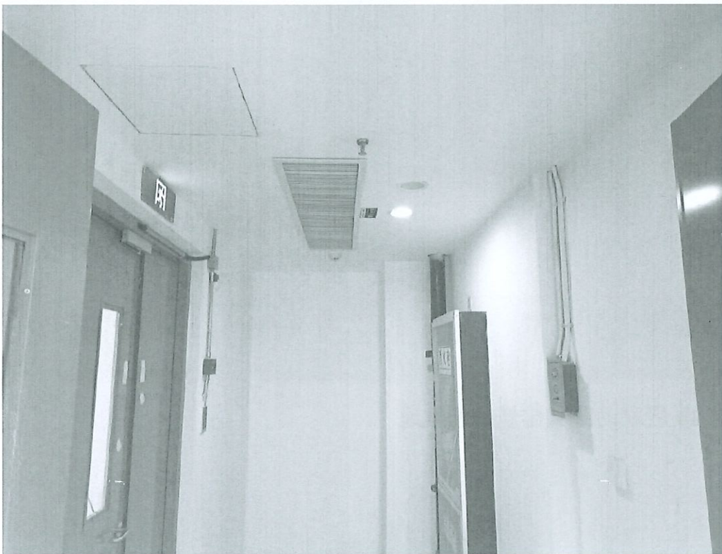
8、8层联动测试，排烟风机启动，风口无风速
