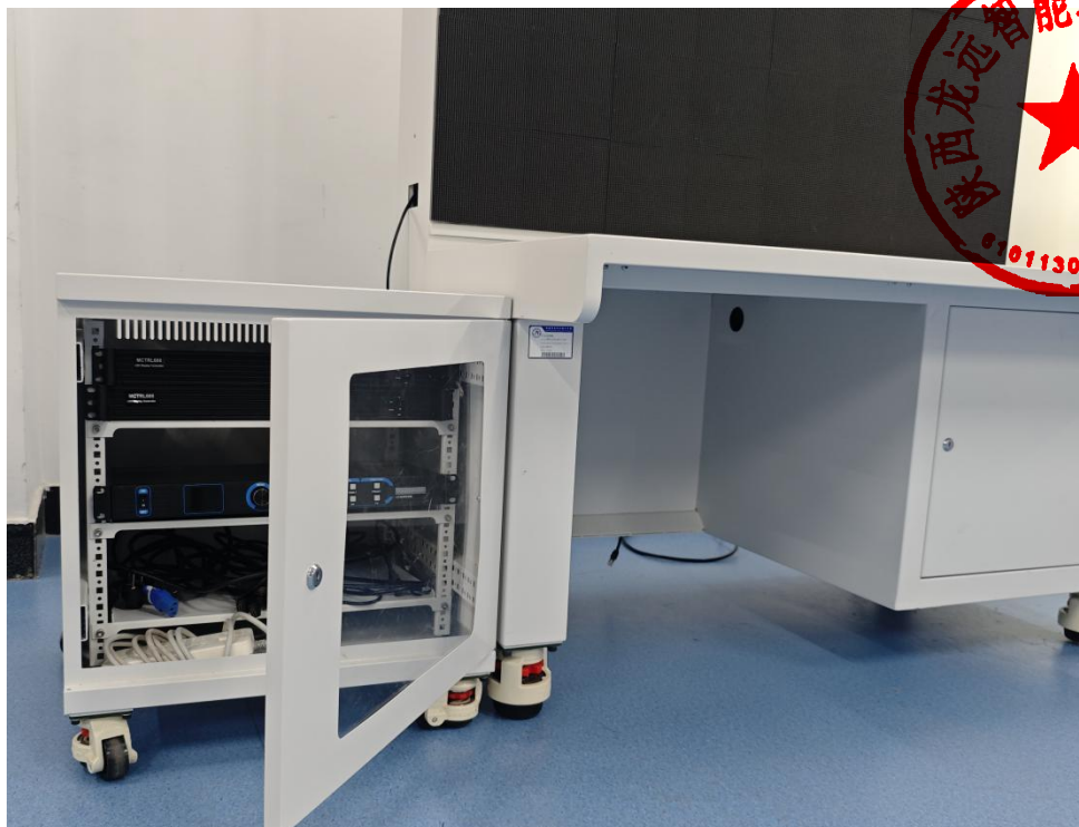
图 43. 实训台配套的储物柜的实拍图（打开状态）
