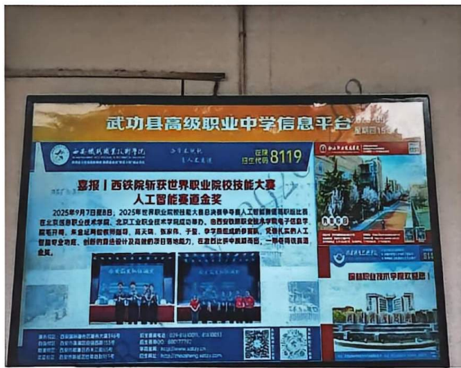
武功职教 安装位置：教学楼一层教室外墙
